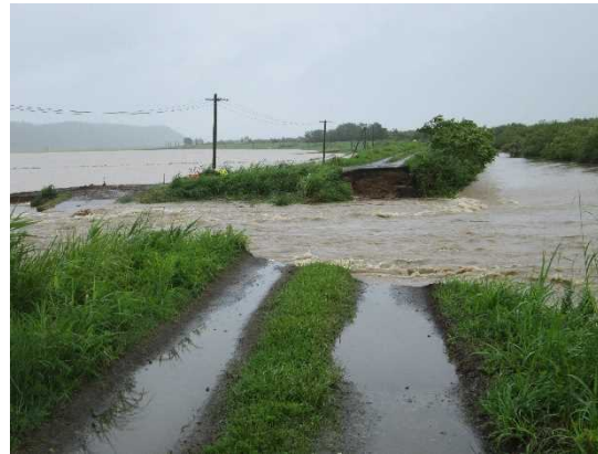
決壊箇所(高瀬川) 8/10 14時
