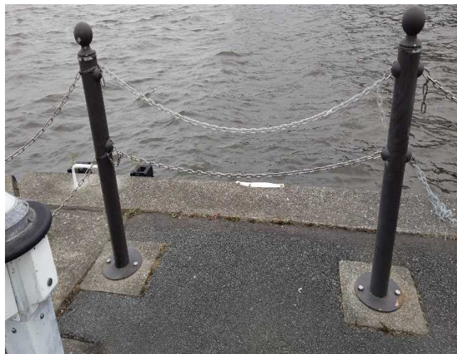
新たにチェーンを設置(措置完了)
