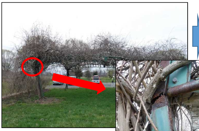
藤棚(支柱)の腐食
