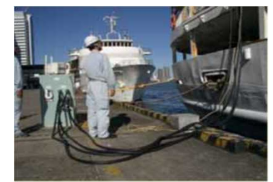
船舶への陸上電力供給
