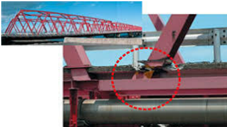
舗装損傷の例
