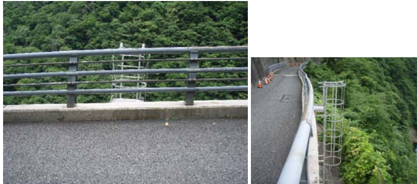
②荒雄湖畔公園(木製標識支柱の腐食・ぐらつき)
