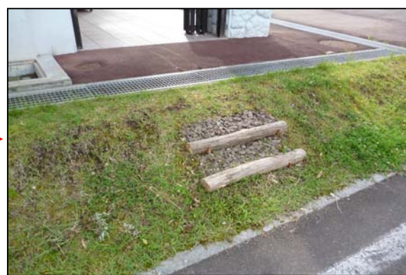
▲腐食した木材を取り替え、また、敷砂利も行い、安全に歩行できるようにしました。
