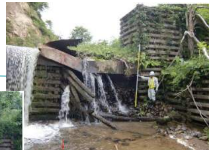
赤砂第1砂防堰堤損傷状況
