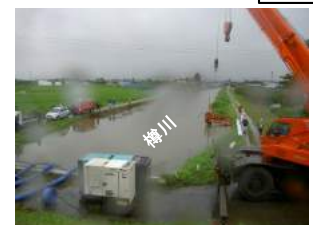
平成25年7月洪水時の状況
