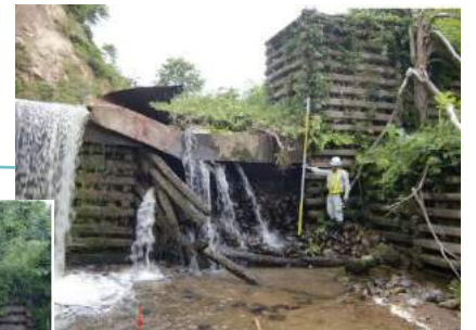
赤砂第1砂防堰堤損傷状況
