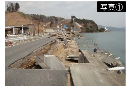
▼津波による国道45号の路面崩壊 (山田町)
