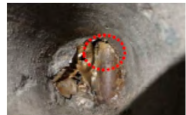
▲グラウト未充填状況
