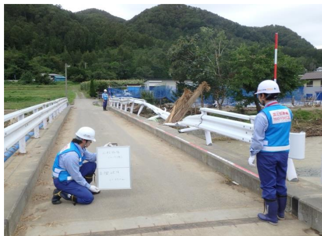
▲ 岩手県岩泉町被災状況調査 （近畿地整TEC-FORCE）
