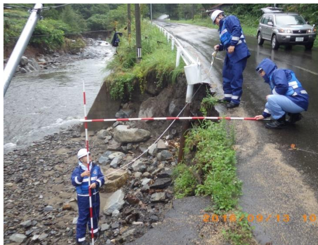
▲ 岩手県宮古市被災状況調査 （東北地整TEC-FORCE）
