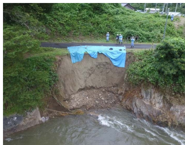
▲ 岩手県普代村（普代川）の被災状況 （北陸地整TEC-FORCE）
