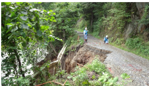
▲岩泉町撰待川における被災状況調査 （北陸地方整備局TEC-FORCE）
