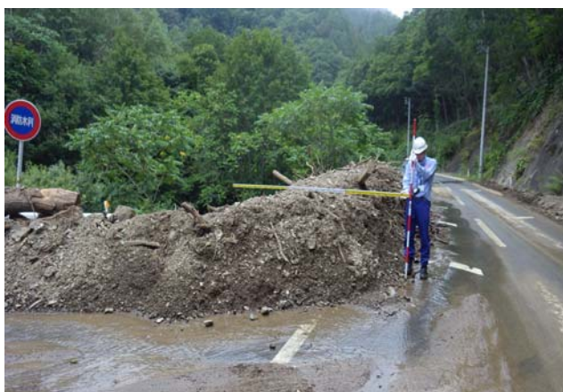
▲岩泉町釜津田小付近における被災状況 調査（中部地方整備局TEC-FORCE）
