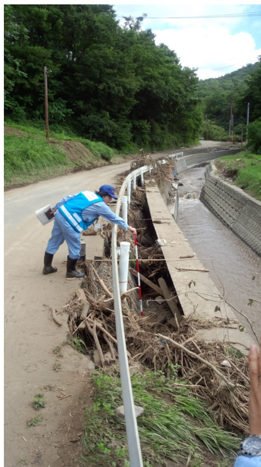
▲岩泉町町道における被災状況調査 （北陸地方整備局TEC-FORCE）
