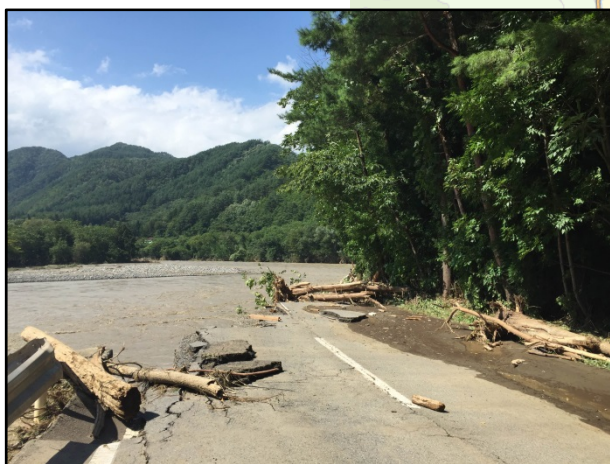
道路崩壊箇所
