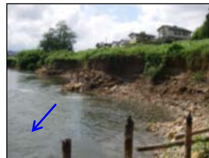
洗掘された河岸
