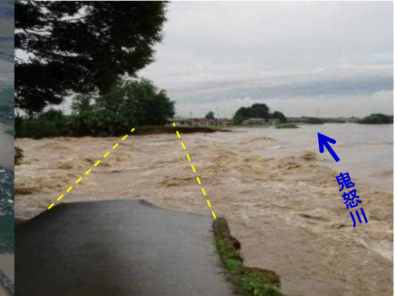
被災状況(拡大写真)
