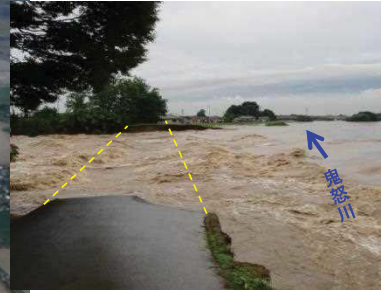
被災状況(拡大写真)
