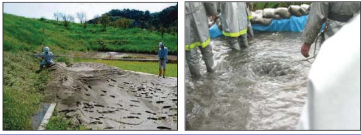
洪水時の堤防等の漏水
