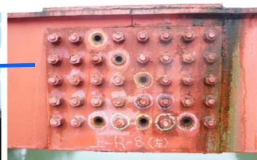
▲アーチリブの高力ボルト破断・抜け落ち状況
