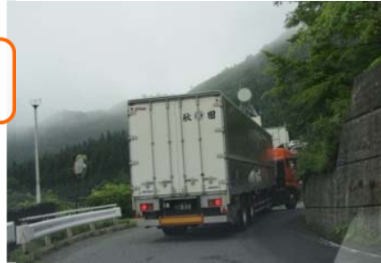
▲ ① 現道における線形不良箇所
