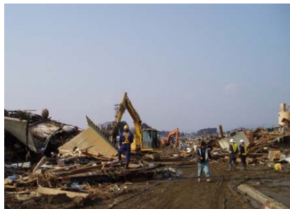
① 国道45号の被災状況
