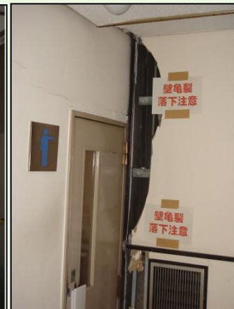
▲廊下壁面落下
