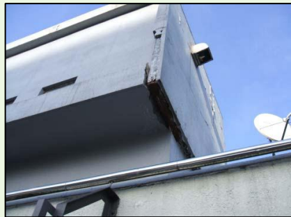
▲外壁材破損・落下
