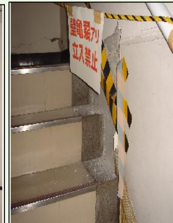
▲階段の壁面のクラック
