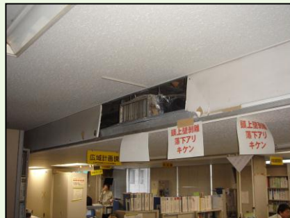
▲空調付近のボード落下
