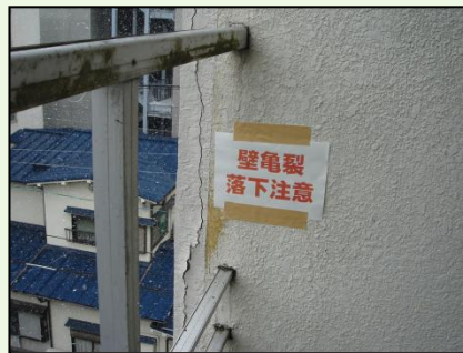
▲外壁のクラック
