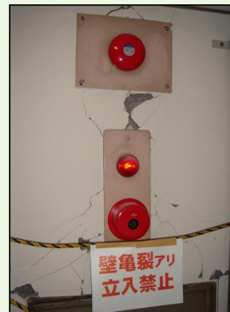
▲消火栓まわりクラック
