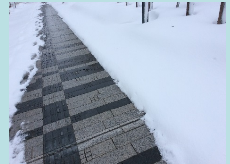
融雪施設正常時
