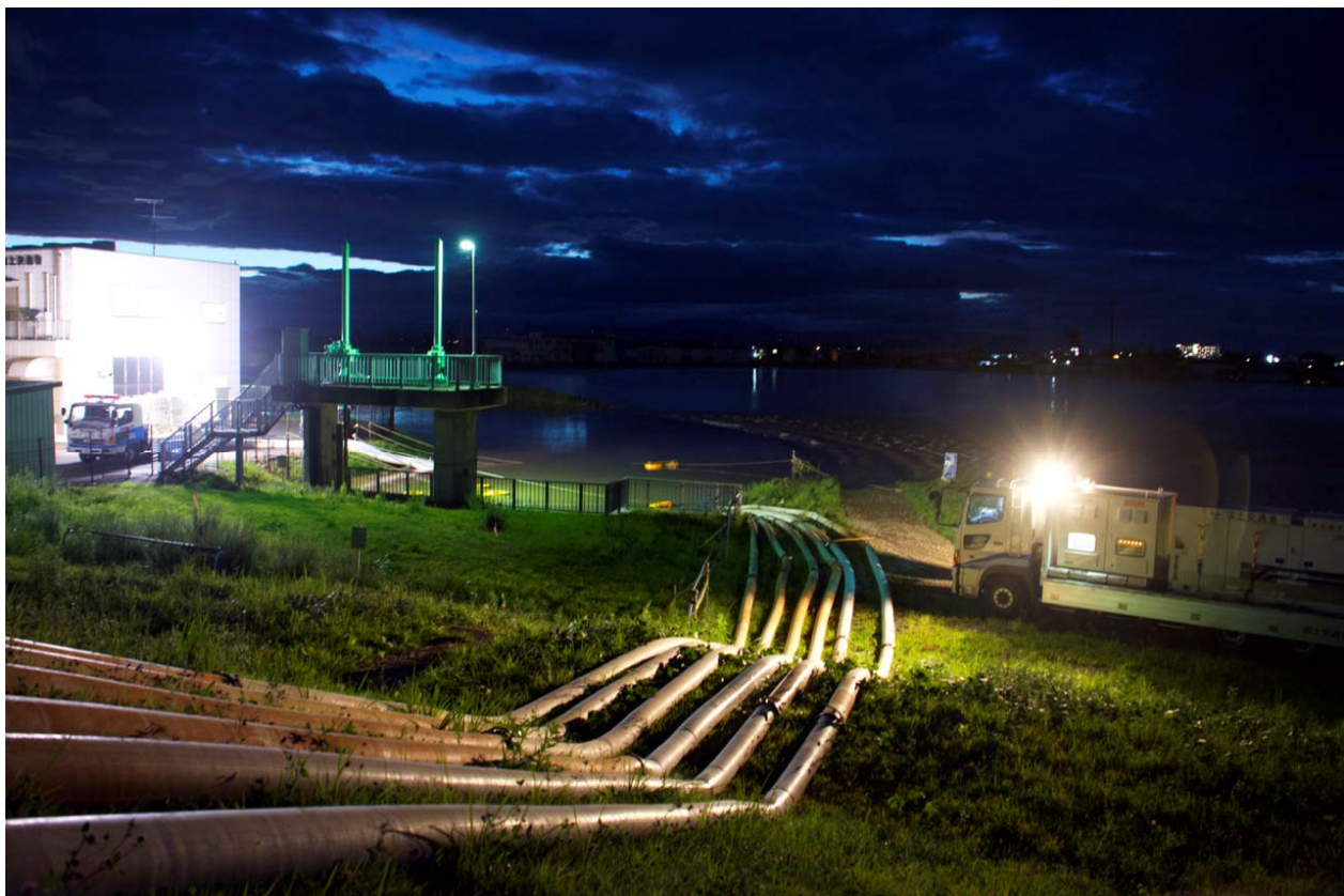
▲大江川夜間排水作業状況①（平成 27 年 9 月 11 日 18 時、大江川排水機場）
