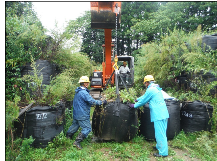
間倉地内において、大型土のうを設置し、浸水被害の未然防止対策を行った。
