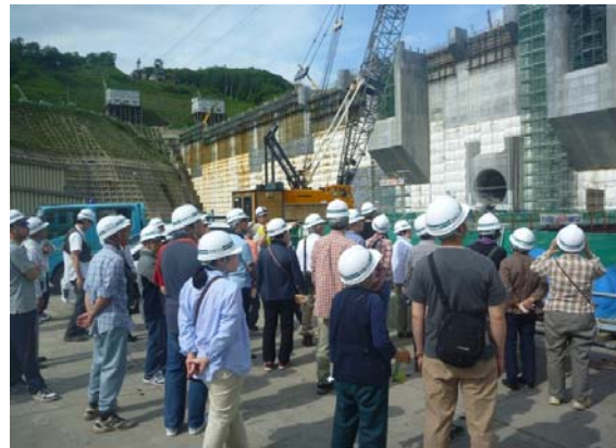
【60m上流の目屋ダムから津軽ダムのコンジットゲートほかの各種ゲート設備を見学する参加者】
