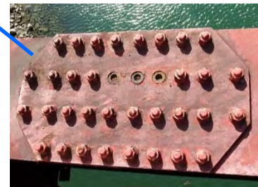
▲補剛桁の高力ボルト破断・抜け落ち状況
