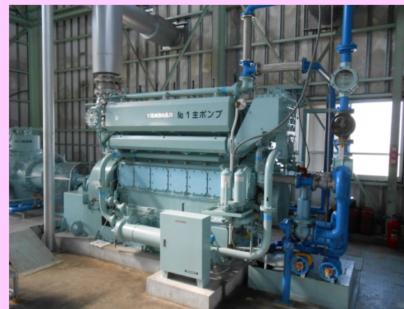
稼働時間が長く、部品の摩耗が進んだポンプ(3.3m 3 /s × 3台)
