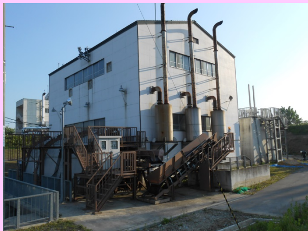
設置から40年以上経過し、老朽化が進んだ現在の排水機場
