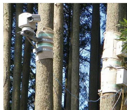
霧島山(新燃岳)の噴火時、緊急的に樹木に固定した監視カメラ
