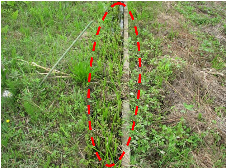
▲ 側溝が土砂で詰まっている上雑草が繁茂している (排水が出来ず雨水等があふれ出し、内水被害の可能性があり危険)
