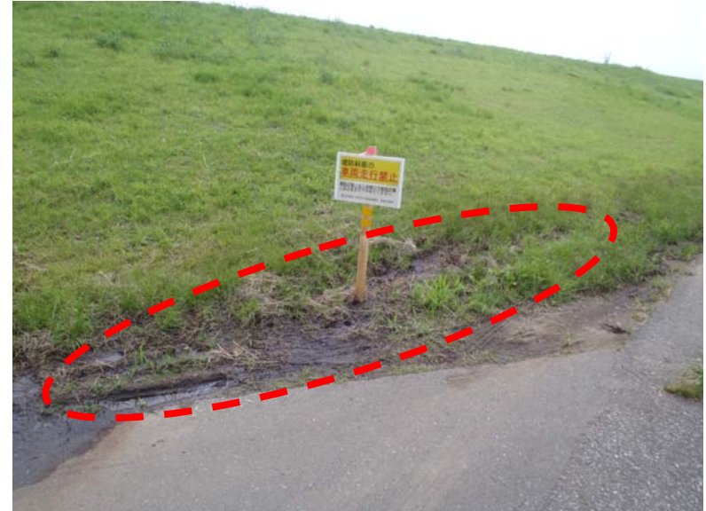
▲ 法尻にタイヤ痕。溝ができ雨水が溜まる (雨水が浸透し、堤防が軟弱になるため危険)
