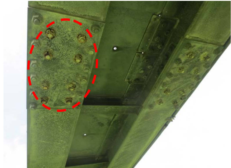
▲ ボルト等の錆び (ボルト等の欠損につながり、安全性が失われるため危険)
