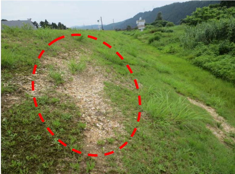
▲ 堤防法面が裸地化 (雨水が浸透し、堤防が軟弱になるため危険)
