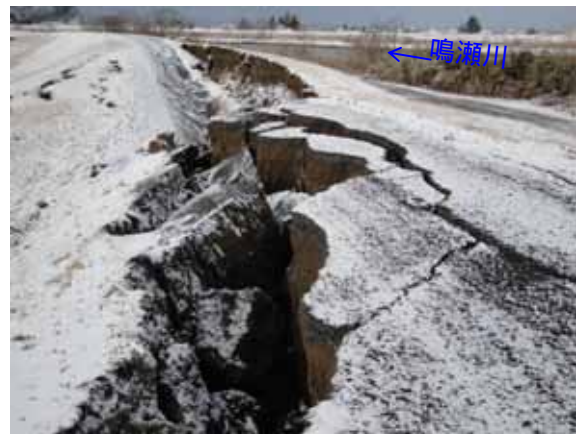
地震により天端沈下と縦断クラック発生 (鳴瀬川左岸11.4k付近 美里町二郷砂山地先)
