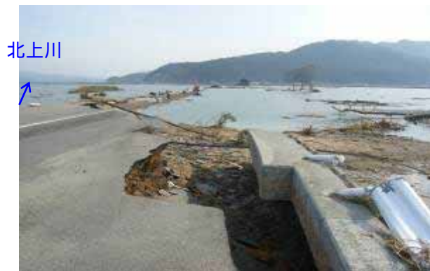
津波による堤防決壊 (北上川右岸4.0k付近 石巻市釜谷地先)
