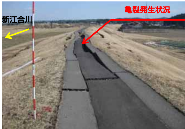
新江合川 下中目地区の被災状況
