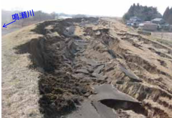
地震により堤体が崩落 (鳴瀬川左岸30.3k付近 大崎市古川下中目地先)
