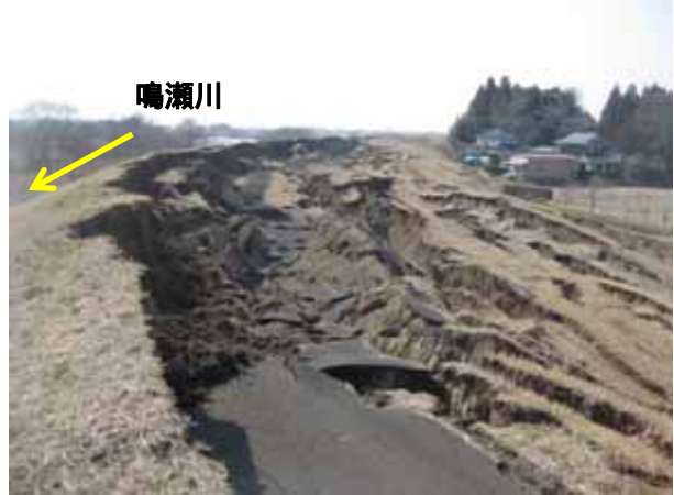
鳴瀬川 下中目地区の被災状況
