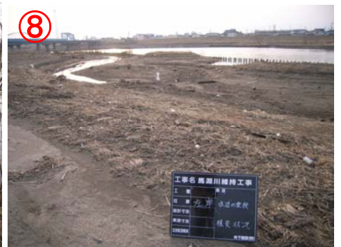
⑧ 【左岸3.4k付近】 水辺の築校土砂堆積
