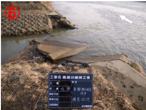
⑥ 【左岸2.4k付近】 樋管堤外水路破損
