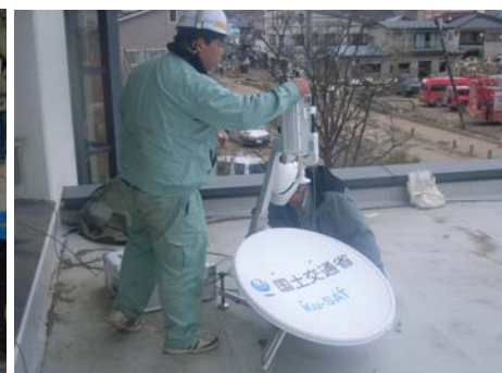
野田村災害対策本部通信用の Ku-sat 設置状況
