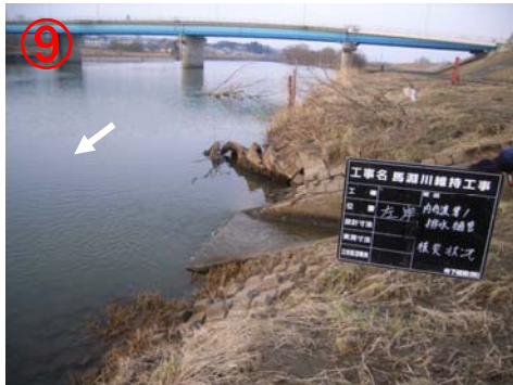
⑨ 【左岸3.8k付近】 護岸(連節ブロック)破損
