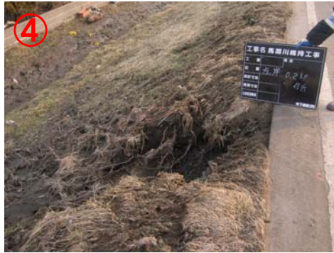
④ 【左岸0.2k付近】 堤防川表法面損傷
