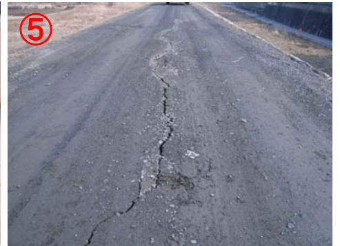
⑤ 【右岸5.3k付近】 堤防天端クラック
