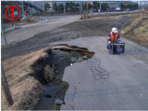
① 【右岸0.0k付近】 川裏坂路損傷
