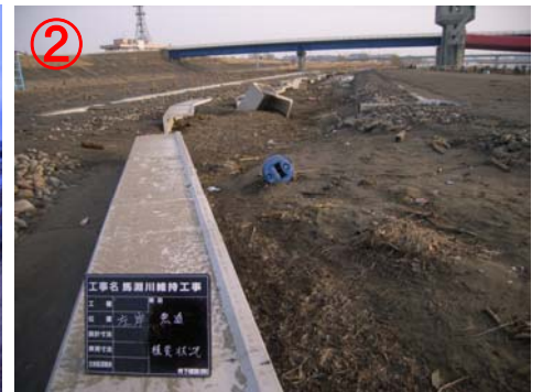
② 【左岸2.6k付近】 魚道土砂閉塞
