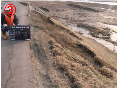
③ 【左岸0.0k付近】 堤防川表法面洗掘
