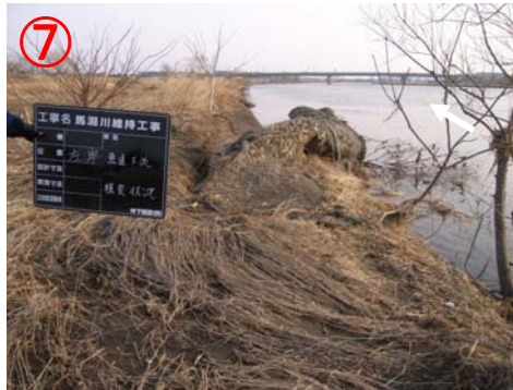
⑦ 【左岸2.5k付近】 護岸(かごマット)破損
