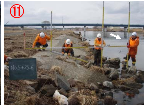
⑪ 【右岸0.95k~1.1k付近】 護岸(空石張)クラック
