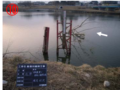
⑩ 【左岸4.0k付近】 水位計変形
