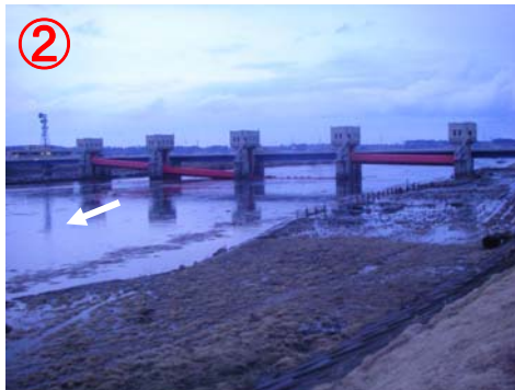
② 【左右岸2.6k付近】 馬淵大堰 戸当り4門変形・ワイヤー固定金具破損
