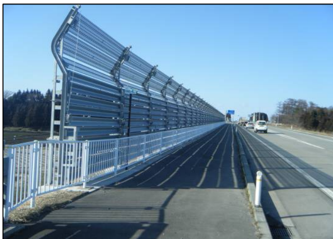
防雪柵存置状況
