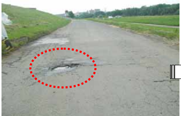
河川公園（北上川南大橋付近） 堤防坂路の舗装に穴があいている →7月13日に補修済み
