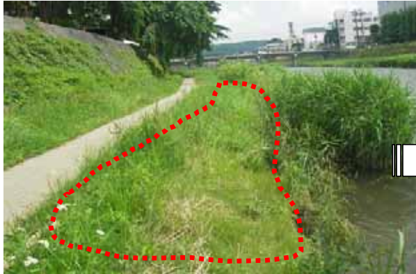
河川公園（中津川中の橋付近） 散策路に草が繁茂し水際が分かりづらい →7月14日に除草済み
