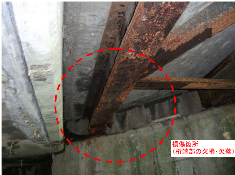
写真2 朝日橋橋側歩道橋(下り) 損傷部分
