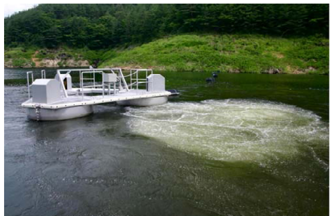
水質保全施設（曝気装置）の稼働状況
