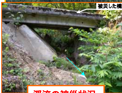
渓流の被災状況
