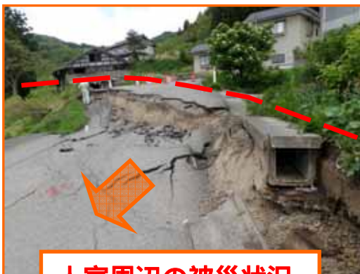
人家周辺の被災状況
