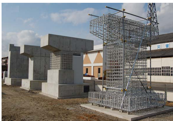
【 橋梁下部工による不適切施工の再現 】
