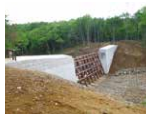
土石流発生前（H24年6月）
