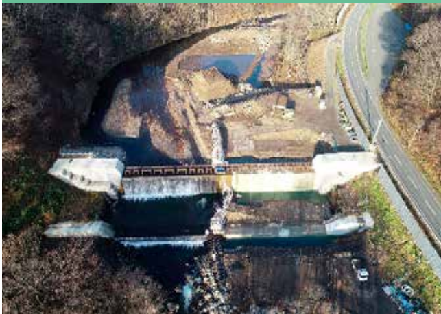
②竜川第2砂防堰堤 R5実施内容：砂防堰堤工(管理用道路)
