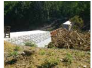
土石流発生後（H25年9月17日）
