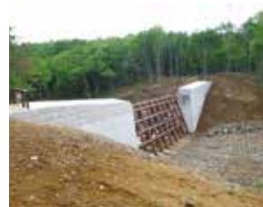
土石流発生前 (H24年6月)
