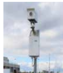
簡易型河川監視カメラ
