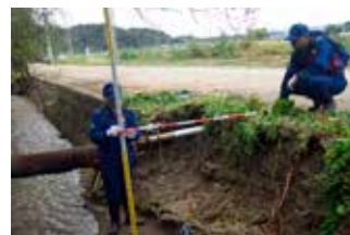
TEC-FORCE活動状況 (令和元年台風19号角田市)
