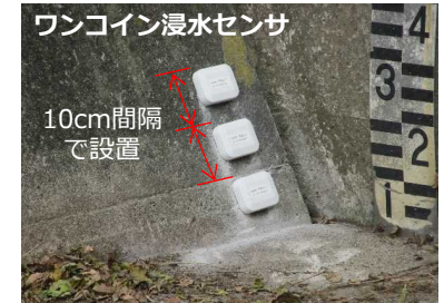
▲浸水常襲箇所に浸水センサ設置 (福島県伊達市)
