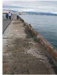
岸壁の老朽化状況
