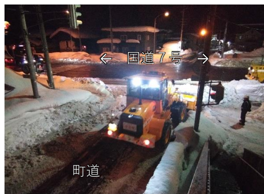
②国道7号に掃き出し
