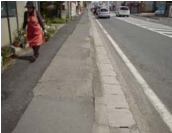
▲民家などへの取付け口の為、凹凸している歩道
