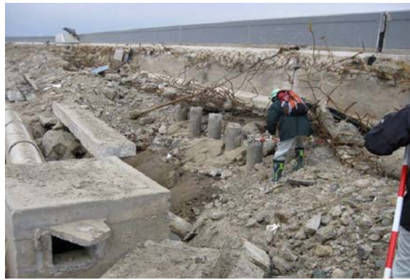
津波の越流による堤防被災状況 (名取川右岸 関上地区)
