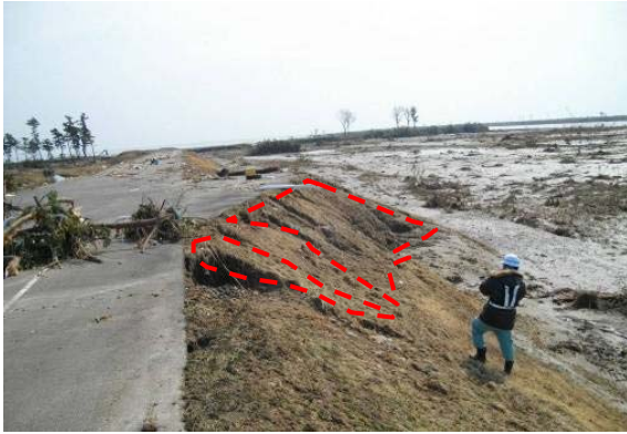
堤防法面の浸食 (名取川左岸 0.3k 付近)
