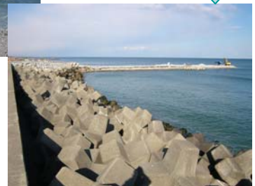
平成23年1月 大量の石を使って ヘッドランドの基礎を作っています 縦堤部の延伸工事中
