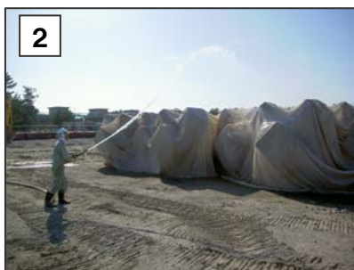
2 コンクリートを固めますが、夏の暑さで早く固まるとひび割れなどが起きやすくなるため、水をかけて温度を下げながらの作業です。
