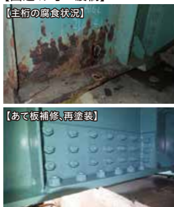
【全桁の腐食状況】
