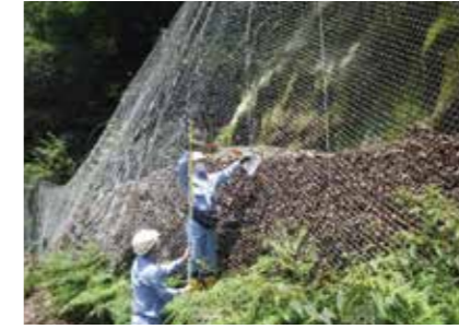
県道槻木田代八重泉被災状況調査
