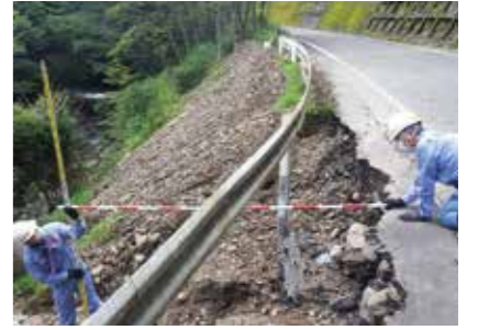
町道 永原泉の被災状況調査
