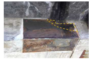
▲ゲルバー部鋼板撤去後状況
