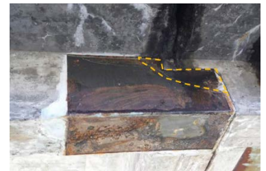
▲ゲルバー部鋼板撤去後状況
